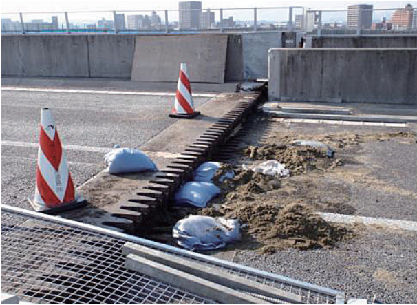
ジョイント部の段差
