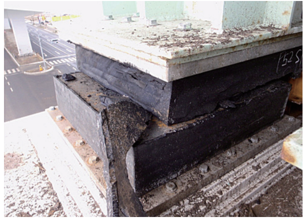
ゴム支承の破断
