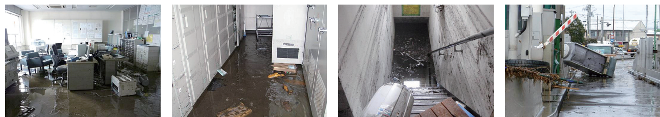
料金事務室浸水状況
